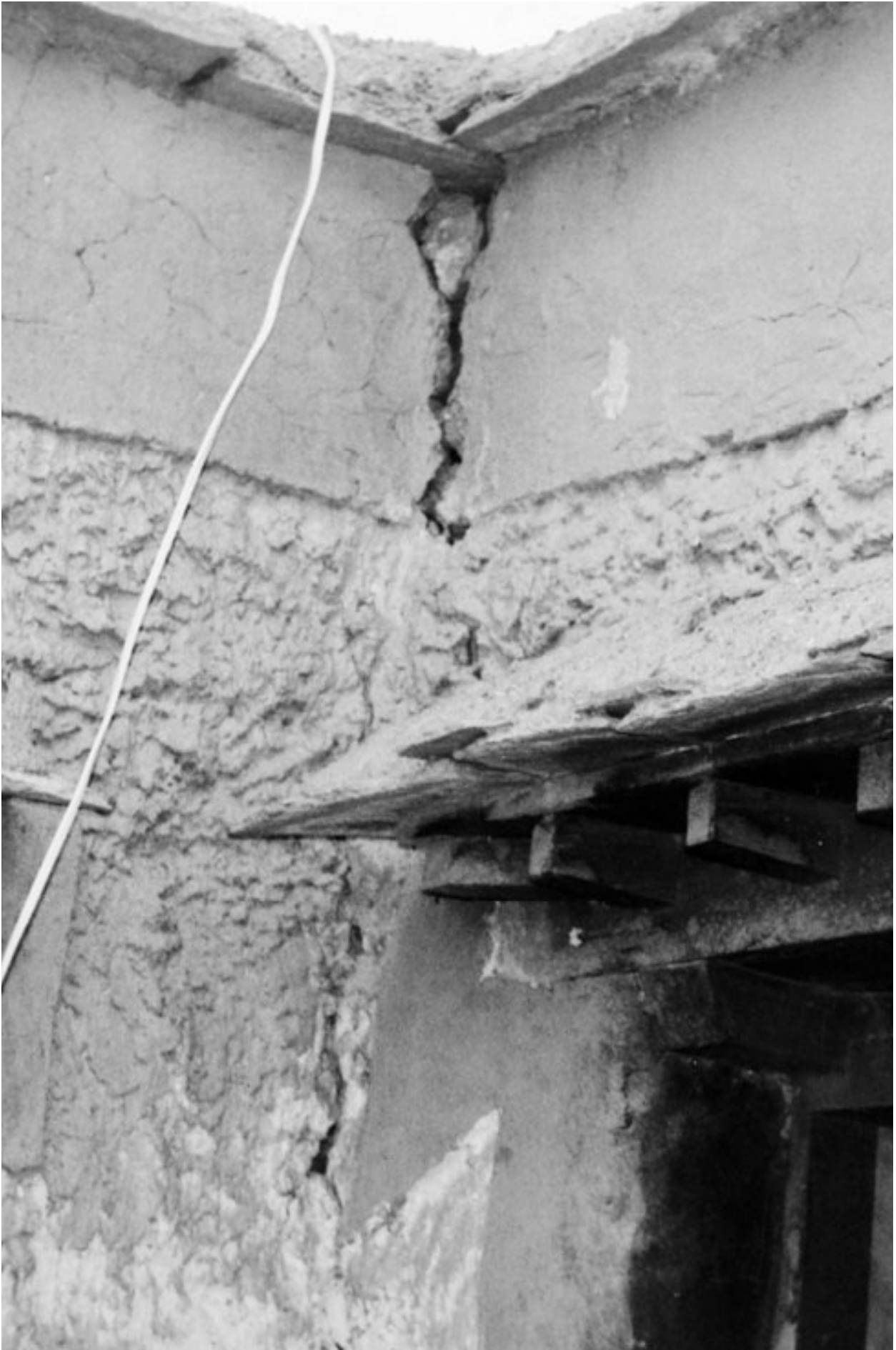
Risse an den Aussenwänden
